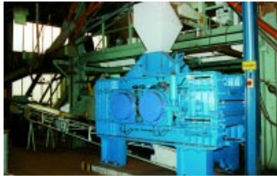
Pilotanlage zur Hochdruckzerkleinerung Pilot plant for high-pressure grinding
